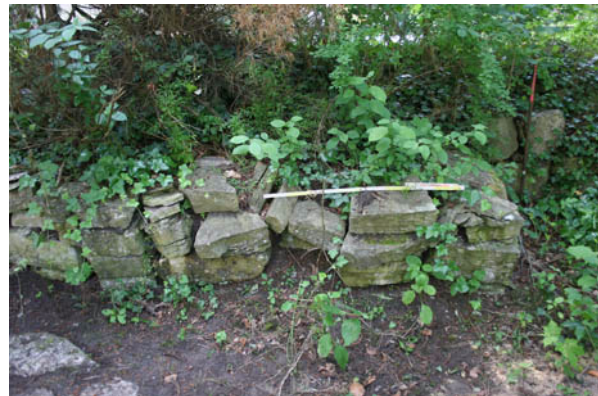
Abb.1: Hausgarten Springer, Berlin-Zehlendorf: Verwerfungen im Bereich der Trockensteinmauer aufgrund der fehlenden Gründung, Foto: Caroline Rolka 2005.
