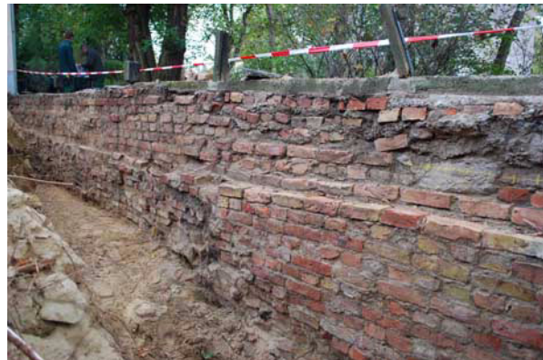
Abb.2: Hausgarten Max Lingner, Berlin-Niederschönhausen: Böschungsmauer aus zweitverwendeten Ziegelsteinen, gebaut ohne Wurzel- bzw. Feuchtigkeitssperre, Foto: Caroline Rolka 2011.
