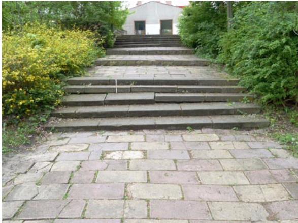
Abb.3: Volkspark Zossen: Verwerfungen im Bereich der Betonplatten an der Treppenanlage des Südeinganges, Foto: Caroline Rolka 2010.
