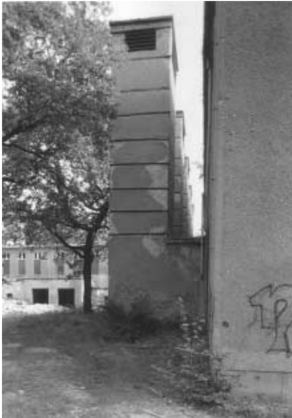
Abb.6: Netzersatzgebäude, Auspuff für Dieselaggregate, Foto: Wolfgang Bittner, 27.8.2002.
