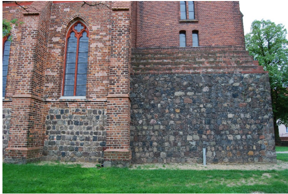
Abb. 4: Stadtkirche St. Moritz Mittenwalde; Kirchenfassade und Turmsockel, Nordseite mit Spuren verschiedener Bauphasen (Andreas Huth, Lukas Böwe)
