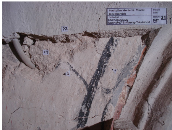
Abb. 8: Stadtkirche St. Moritz Mittenwalde; Chorumgang, Wand neben dem Sakristeieingang, Reste einer floralen Gestaltung in Kalkfarbe, Putze teilweise abgängig bzw. entfestigt (Andreas Huth, Lukas Böwe)
