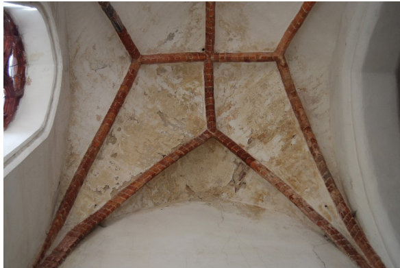
Abb. 6: Stadtkirche St. Moritz Mittenwalde; Gewölbejoch im südlichen Seitenschiff, Schäden an historischen Putzen durch Wassereintrag (Andreas Huth, Lukas Böwe)
