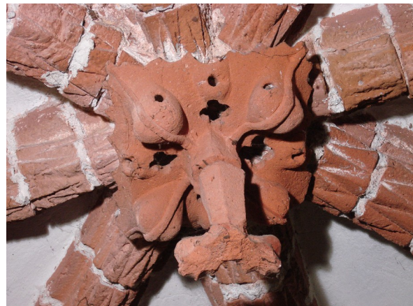
Abb. 7: Stadtkirche St. Moritz Mittenwalde; Sakristei, Netzgewölbe mit Abhängling, Rippen mit Kerbmuster, Fassungen durch Sandstrahlen Ende der 50er Jahre weitgehend zerstört (Andreas Huth, Lukas Böwe)
