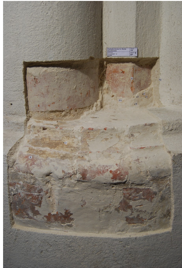
Abb. 5: Stadtkirche St. Moritz Mittenwalde; Pfeiler auf Nordseite der Kirche, Freilegung der gotischen Formsteine und der aufliegenden Fassungen (Andreas Huth, Lukas Böwe)
