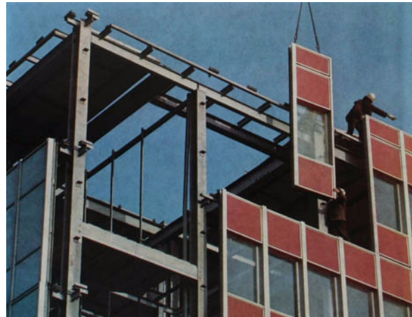
Abb.11: Montage von Vorhangfassadenelementen an einem Mehrzweckgebäude vom Typ «Leipzig» aus dem Katalog des Metalleichtbaukombinats, um 1977.
