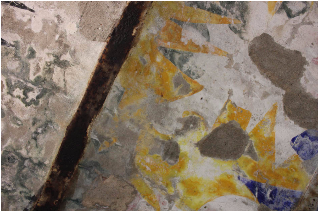
Abb.16: Hans Holtorf, Wandmalerei im Erdmann-Holtorf-Pavillon, Deckendetail mit Putzausbesserungen, Zustand 2013.
