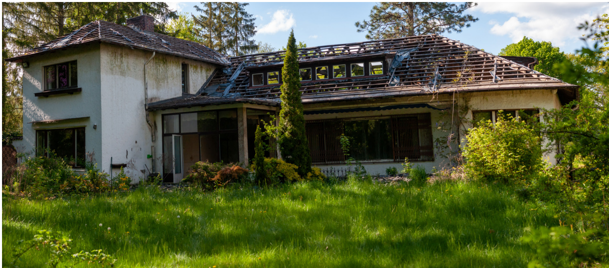
Abb. 9 Haus Marlene Poelzig, Blick vom Wald aus, Zustand Juni 2021, die Überformungen durch ein Walmdach und der Rückbau des Obergeschosses haben den ursprünglichen sachlich-modernen Charakter stark verändert hin zu einem „Häuslebau“
