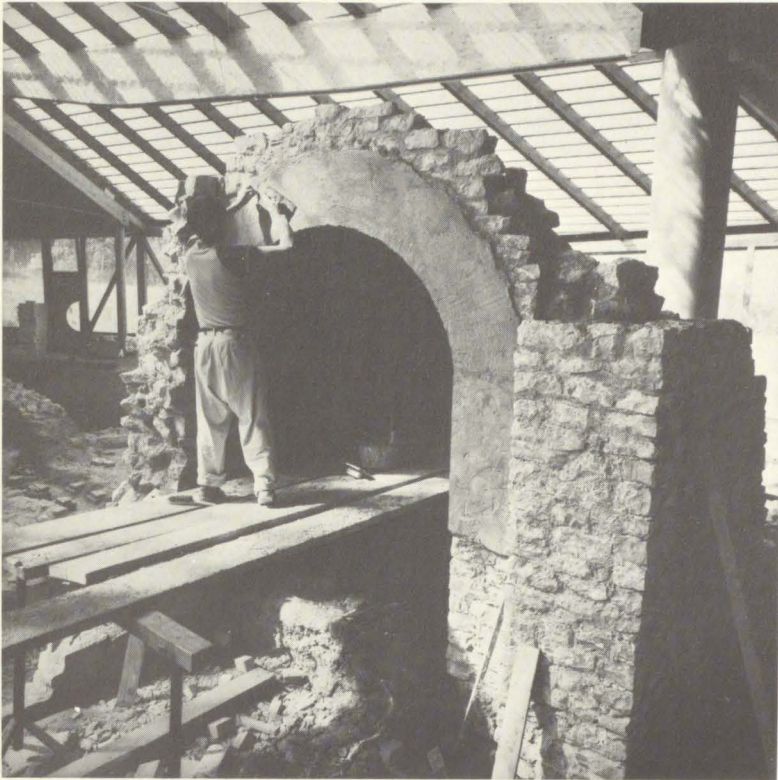
Über einem Wasserbecken der Weißenburger Thermen wird eine kleine Apsis rekonstruiert. Foto Bayer. Landesamt f. Denkmalpflege.
