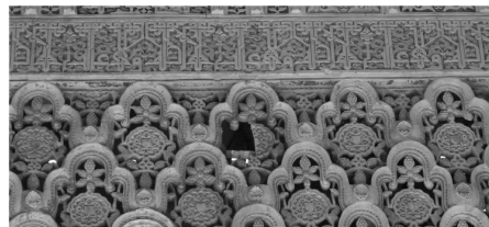
Fig. 7. Alhambra, Patio de los Leones, paño de sebka roto en el área del pabellón occidental, estado del 2008. Fotografía: Francine Giese-Vögeli, diciembre 2008.
