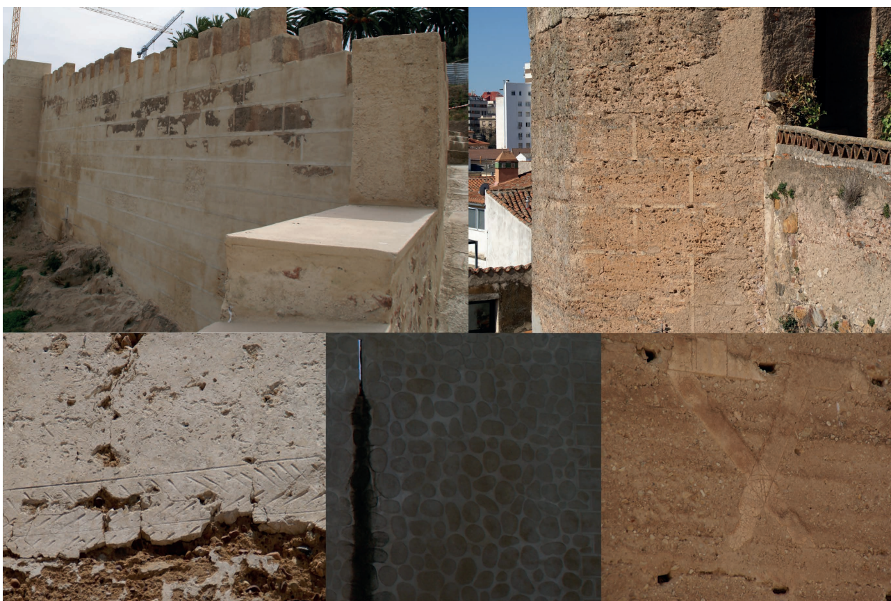
Fig. 1. Ejemplos de diferentes tipos de decoración con Falso Despiece de época almohade. Arriba a la izquierda: Alcazaba de Badajoz, Combinación de cintas horizontales y falso despiece de sillares. Arriba a la derecha: Torre Redonda del recinto fortificado de Cáceres, Detalle de la decoración de falso despiece de sillares. Marzo, 2012. Abajo a la izquierda: Castillo de Baños de la Encina (Jaén), Detalle de falso despiece con motivos en “espina de pez”. Mayo, 2012. En el centro: Alcazaba de Badajoz, Ejemplo de falso despiece de mampostería. Marzo, 2012. Abajo a la derecha: Castillo de la Mola (Novelda, Alicante), Decoración de falso despiece con motivos en cruz insertados. Agosto, 2012. Fotografías: Dolores Villalba Sola.
