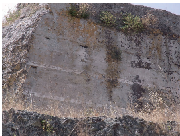
Fig. 3. Castillo de Alcácer do Sal (Alentejo Litoral, Portugal), Torre del Aljibe, Detalle de los restos de decoración de falso despiece, en este caso cintas horizontales. Fotografía: Dolores Villalba Sola, Junio, 2014.
