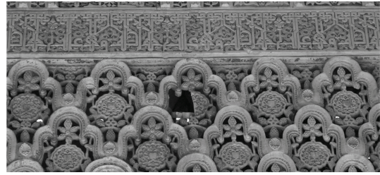
Abb. 9. Alhambra, Patio de los Leones, aufgebrochenes sebka-Netz im Bereich des westlichen Hofpavillons, Zustand 2008. Foto: Francine Giese-Vögeli, Dezember 2008.
