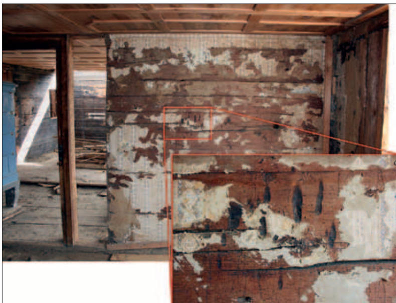
7 Flammenförmige Brandspuren an der Ostwand der Nebenstube im Haus Grubenstrasse 37, Oberägeri (Kanton Zug).
