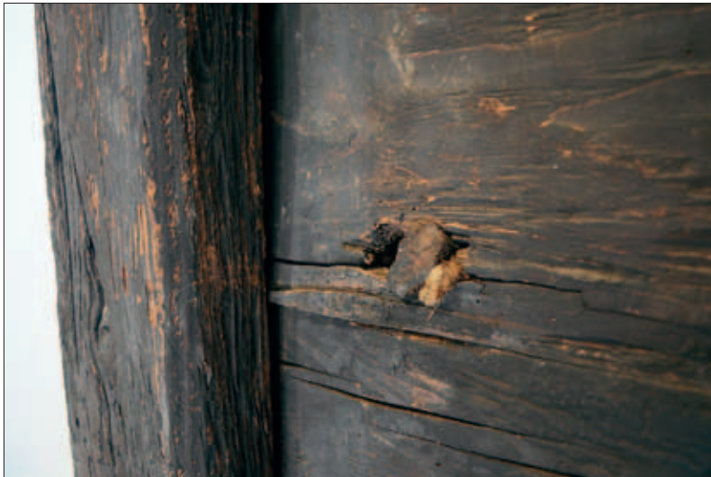
3 Verpflöckung mit eingeklemmtem Hanfbündel neben dem Türständer, Adligenswil-Letten (Kanton Luzern).
