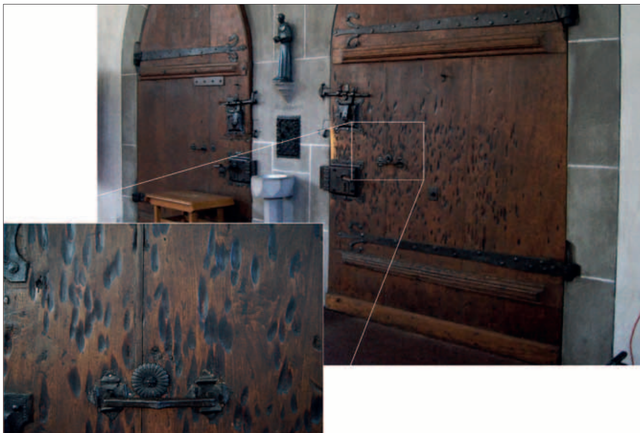
8 Zahlreiche flammenförmige Brandspuren auf dem gesamten Türblatt (innen) der St. Oswald-Kirche in Zug. Im mittleren Bereich auf Stehhöhe dicht gehäuft, zum Boden hin ausdünnend.
