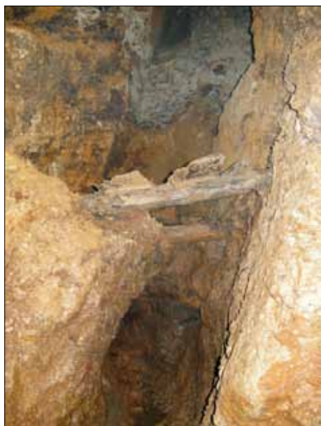
Abb. 11: Dippoldiswalde. In situ -Arbeitsbühne mit drei Deckbohlen auf zwei zwischen die Stöße geklemmten Einstrichen.
