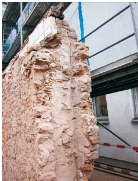
Abb. 3 (ganz oben): Niederstraße 47–49. Bau- befunde in der südlichen Außenmauer.
