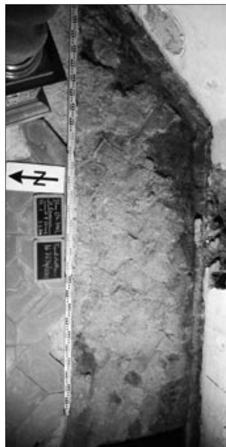
Abb. 17: Glonn, Filialkirche St. Emmeram. Mörtelbett eines älteren Backsteinbodens (frühes 17. Jh.) und eines jüngeren Ziegelplattenbodens (1693, ganz oben) im Süden des Chores, von Westen.
