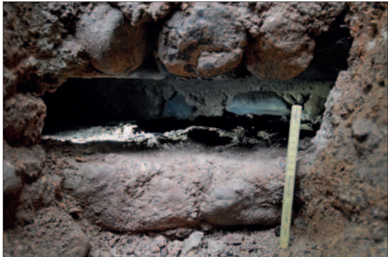
5 Blick gegen Norden in den „Kanal“ bei der Auffindung im Innern der Mauer.
