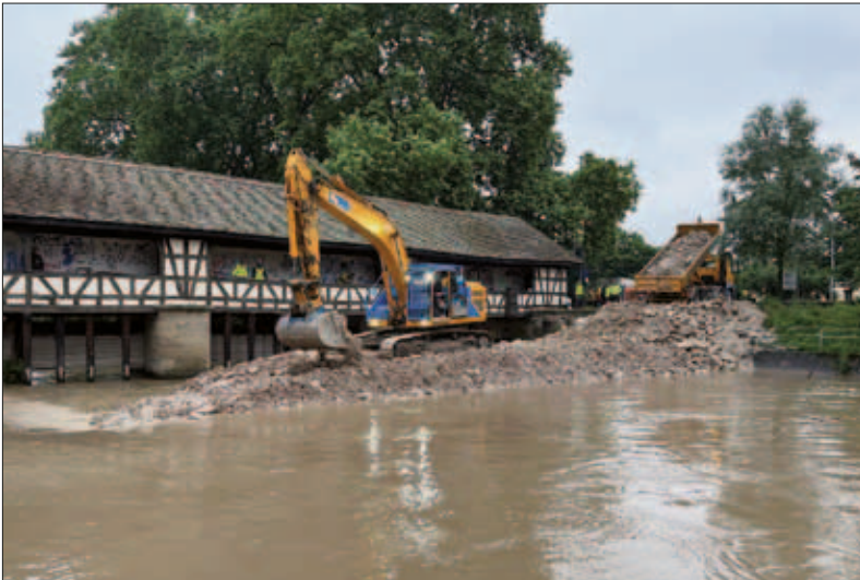
24 Errichtung eines provisorischen Damms zum Schutz des neuzeitlichen Wasserhauses sowie der dahinter gelegenen mittelalterlichen Altstadt von Esslingen im Zuge des Hochwasser Anfang Juni 2024.
