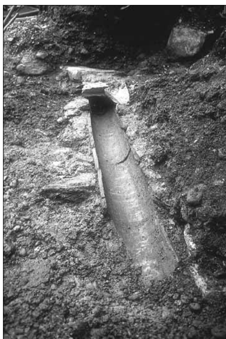
Abb. 3: Abgedeckter Teil der ältesten mittelalterliche Wasserleitung der Schweiz aus dem 12. Jahrhundert am Fronwagplatz.
