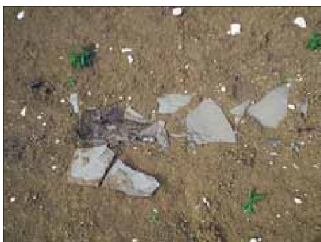
Abb. 4: Aufsicht auf einen Drainagekanal, dessen Abdeckung aus Schieferplatten teilweise abgenommen wurde.
