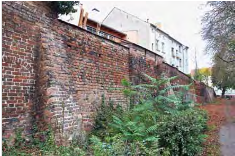
Abb. 11: Ansicht der Stadtmauer von der Feldseite in der Altstädtischen Wassertorpromenade. Man erkennt die Abfolge der mauerbündigen Wiekhäuser und Setzungen der Mauer.
