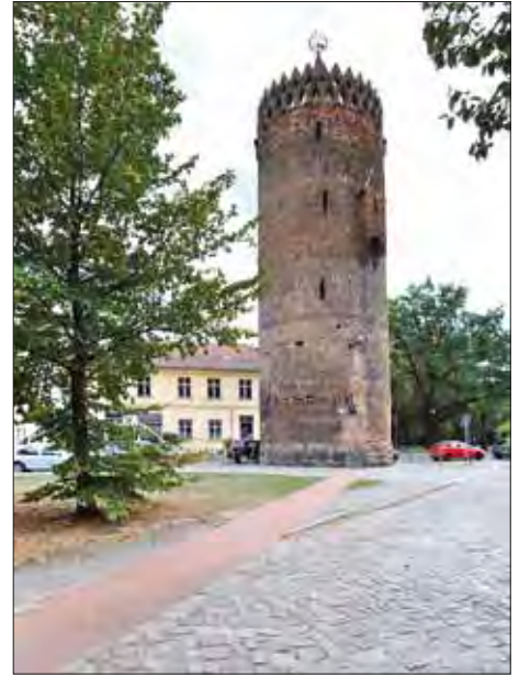
◁ Abb.8: Ansicht der Stadtmauer von der Feldseite mit Ansatz von Wiekhäusern. Die ungleichmäßige Setzung ist bedingt durch unzureichende Fundamentierung im Wallkörper.
