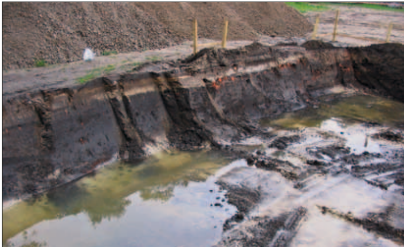
Abb. 15: Brandenburg, Ortsteil Klein Kreuz. Durch den Mühlenstau überflutete spätslawische Siedlungsbefunde in einer Baugrube.
