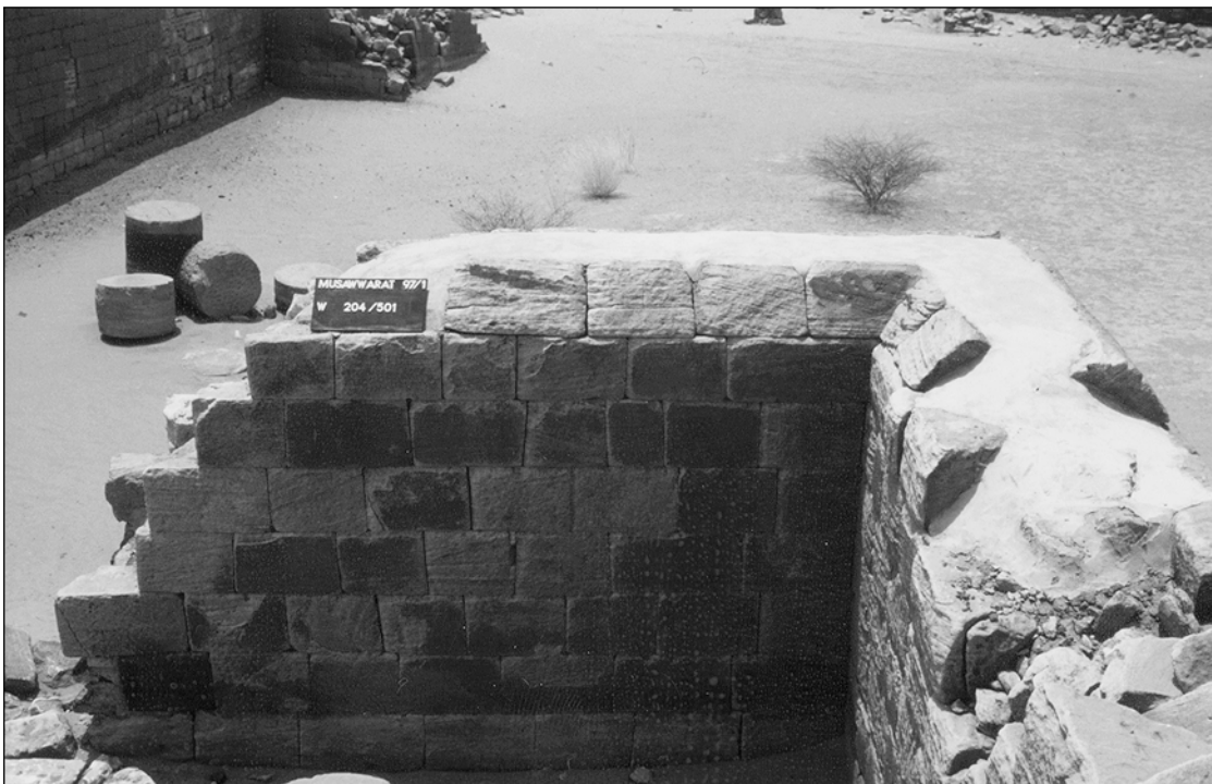
Abb. 7: Mit Mörtel abgedeckte Mauer (Neg.Nr. 1260-8)
