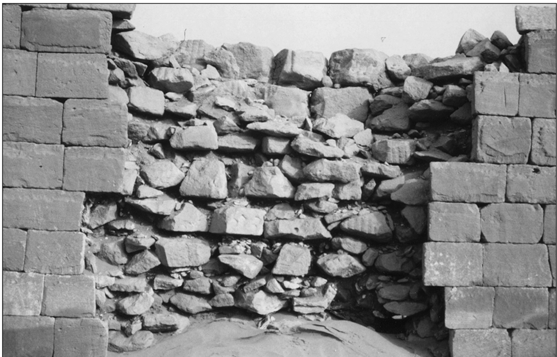
Abb. 3: Ausbruch einer Mauerschale in der Großen Anlage (Neg.Nr. 1210-11)
