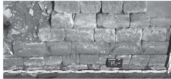
Abb. 36 In der Außenfassade sichtbare Risslinie (s. Pfeil) auf der 1. Lage, darüber Bossenblöcke mit von oben nach unten geringerem Abarbeitungszustand
