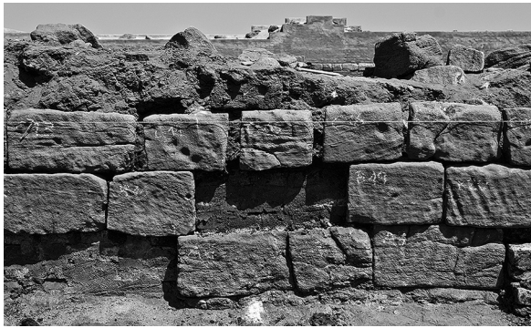
Abb. 27: Durch Kantenverwitterung entstandene (hier bereits vermittelte) Lückenbildung in einer durchgehenden Blocklage der Südfassade nach ihrem Wiedereinbau. In den beiden Blocklagen darunter mussten Originalblöcke teilweise durch Ziegel ersetzt werden.
