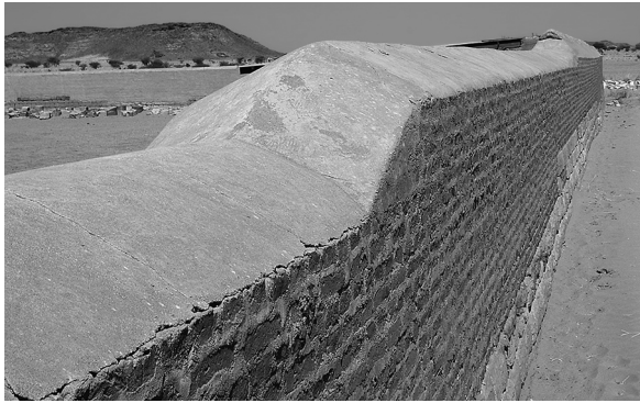
Abb. 5: Die bisherige Abdeckung der Mauer 227/E mit schräg abfallenden Eselsrückenimitationen.
