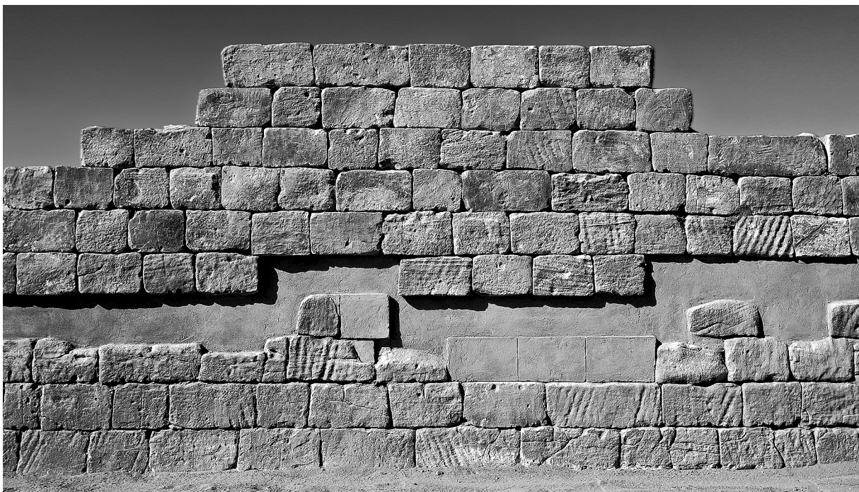
Abb. 26: Bereich der Südfassade mit aus der original erhaltenen Bausubstanz ausgebauten und durch Ziegel ersetzten Blöcken sowie der darüber verlaufenden Trennlage.
