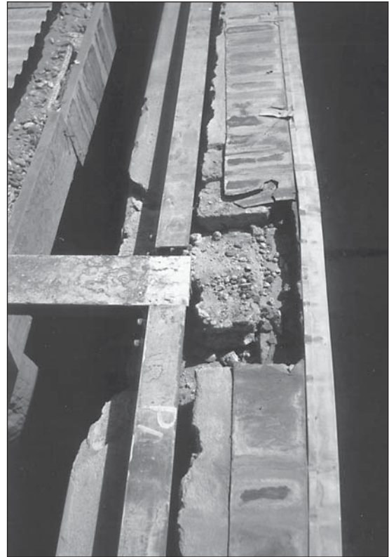
Abb. 6: Schadstelle an der nördlichen Längsseite nach Abnahme der Perspex-Platten (Foto: R. Wenig).
