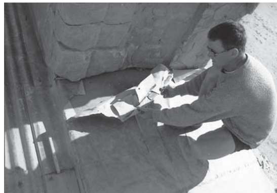
Abb. 11: Die schadhafte Zinkabdeckung zwischen den Pylontürmen (Foto: R. Wenig).
