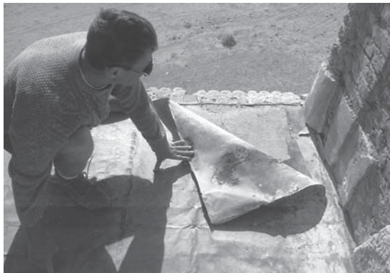
Abb. 10: Die schadhafte Zinkabdeckung zwischen den Pylontürmen (Foto: R. Wenig).
