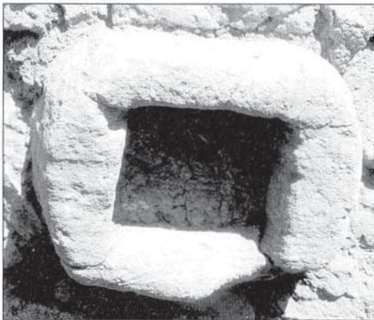
Abb.5: Ansicht des Mündungsblockes der Wasserleitung in der Ostwand des Beckens. Sohle lippenartig zugearbeitet (oder erodiert?), annähernd quadratischer Innenquerschnitt. Rissbildung v.a. in den unteren Ecken erkennbar, keine Fugen!
