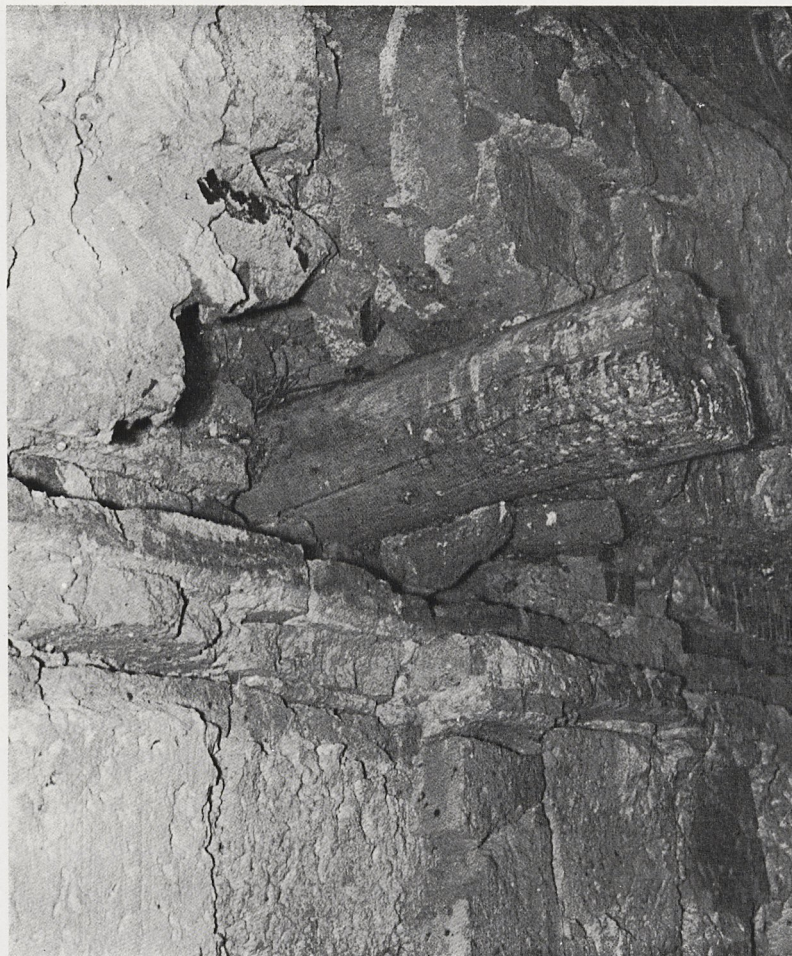
33 Soltanieh, cupola del mausoleo. Segni di armature rimasti infissi nella muratura.
