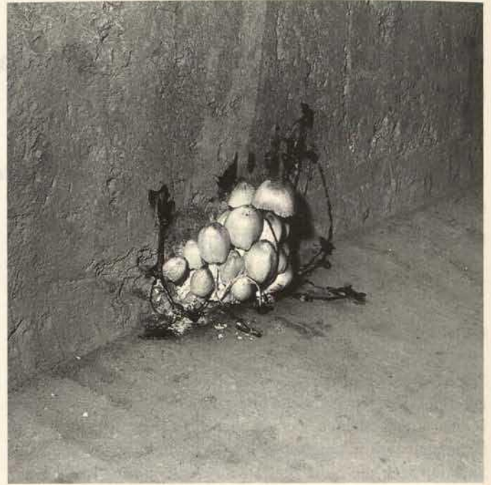
Abb. 2. Ständerpilze (Basidiomyceten) an einer Zugangsrampe; Grube 2, T16, 04. 04. 1995
