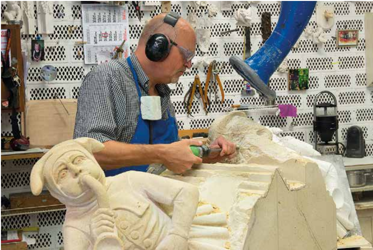
Steinmetzarbeiten am Kölner Dom Stonemasonry at Cologne Cathedral Travaux de taille de pierre dans la cathédrale de Cologne
