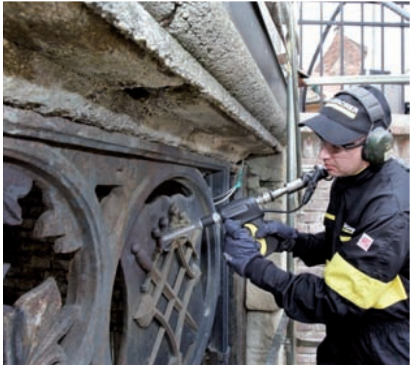
4 Anwender des Trockeneisstrahlverfahrens mit entsprechender Schutzbekleidung wie Gehörschutz, Overall, Schutzbrille oder Helm mit Sichtschutz und Handschuhen.
