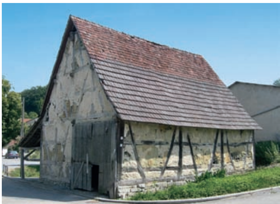
1 Krautheim-Unterginsbach (Hohenlohekreis), ehemalige Zehntscheune des Fürstbistums Mainz, ein am Eckständer 1700 (s. o.) datierter Fachwerkbau mit giebelseitig erschlossener Tenne. Die Scheune hat bis heute keinerlei Lüftungselemente in Wänden oder Dach. Zustand 2007.
