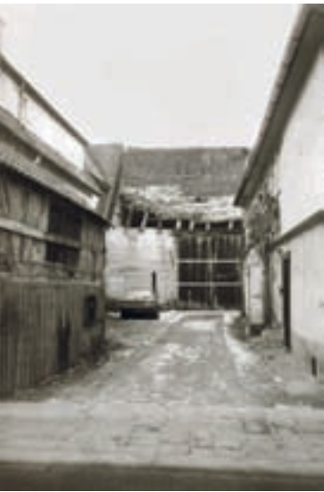
1 Scheune Hauptstr. 20 in Gerlingen von der Hofseite, Zustand 1995, mit offensichtlichen Schäden an der Dachkonstruktion.
