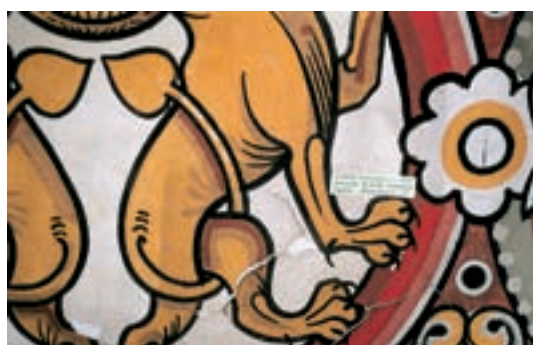
9 Decke, östlicher Bereich, sich abhebende Malschicht, die sich verwölbt hat, dadurch wird der Mörteluntergrund sichtbar.
