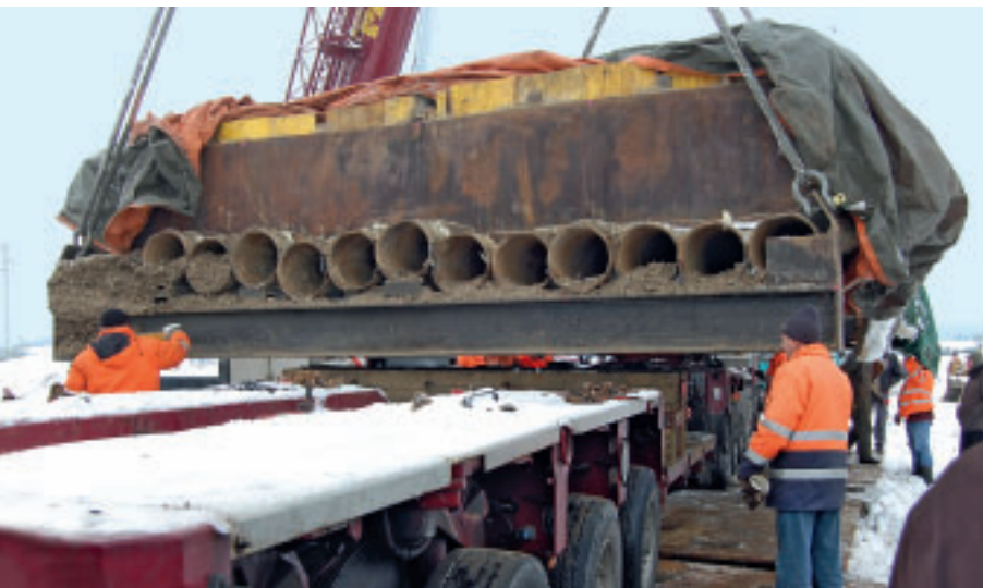
4 Bettelbühl-Nekropole, 28. Dezember 2010: Das Grab wurde mit Stahlrohren unterbohrt, mit Stahlblechen wannenartig umfangen, im Block gehoben und abtransportiert.
