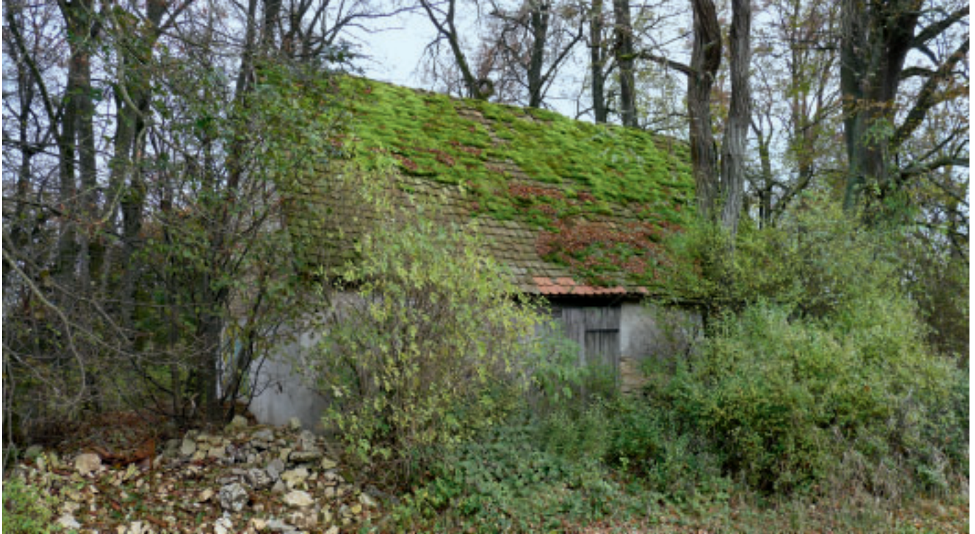
8 Lagerkeller bei Dettingen am Albuch mit deutlichen Bauschäden.
