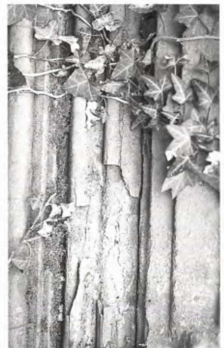
■ 3 Fenstersims von der Akademie, Planie, Sandstein, um 1740 (Inv. Nr. 288b), Detail. Schadensbild: Substanzverluste, Schalenbildung, Bewuchs. Foto: J. Weigle.
