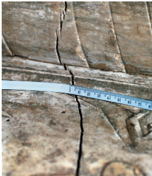
10 Ansicht der verwölbten Reliefplatte „Albruck“, Zustand 1999. Foto: Aedis, Möglingen
