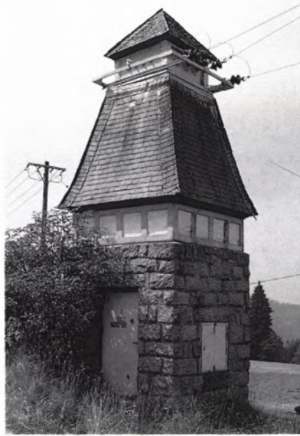
■ 7 Die Elektrizitätsgesellschaft Triberg erstellte Transformatorenstationen dieser Bauart in ihrem ganzen Versorgungsgebiet. Diese Station in Schonach ist als einzige davon noch erhalten.
