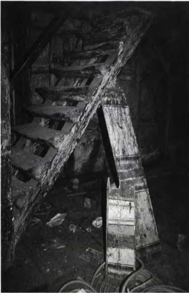
6 DIE MEISTE HISTORISCHE BAUSUBSTANZ wird bei der Entrümpelung und unsachgemäßen Freilegung von Deckenbalken und Wandbekleidungen zerstört. Hier sollte bereits ein Restaurator aus dem Handwerk dabei sein.
