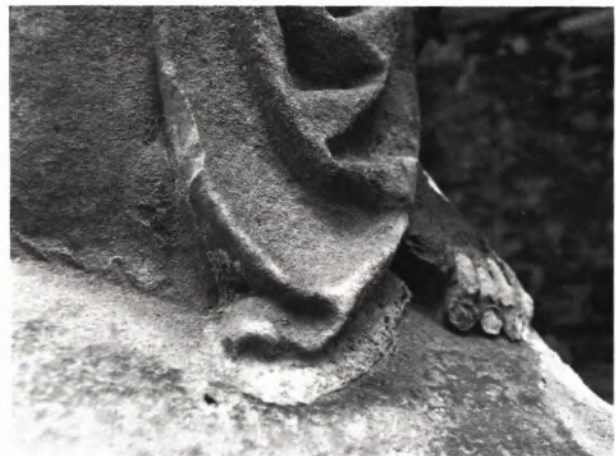
6 SCHADENS-BILD am Fuß.
