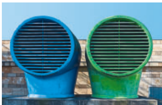
1 Stuttgart, Neue Staatsgalerie, Abluftrohre.
