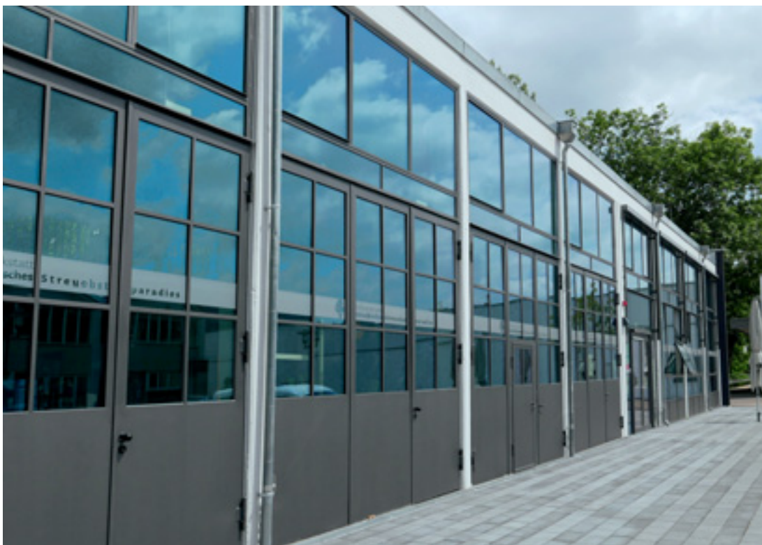
10 Südfassade mit Rekonstruktion des bauzeitlichen Farbkonzepts und des Fassadenelements nach Ausbau der Trafostation. Blick nach Nordosten.
