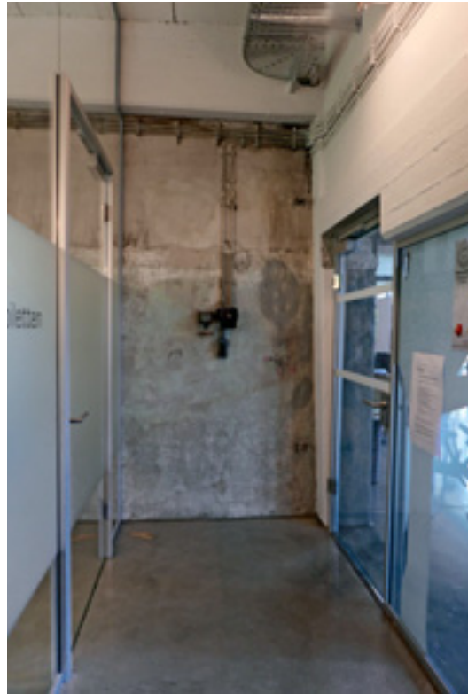
9 Im Bereich der Toiletten in der ehemaligen Tischlerei konnten Oberflächen und Installationen im zuletzt angetroffenen Zustand erhalten werden.
