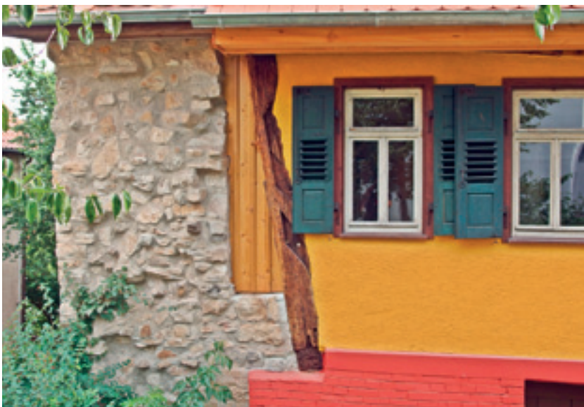
5 Fassadendetail nach Instandsetzung mit Bruchkante der Stadtmauer und spätmittelalterlichem Eckständer mit Blattsassen im Jahr 2017.
