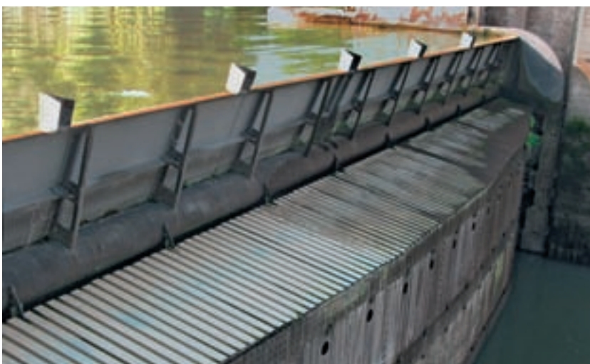
4 Aufsicht auf einen der drei Wehrverschlüsse mit Trapezblechabdeckung und Torsionsrohr, auf welchem die Aufsatzklappe befestigt ist.
