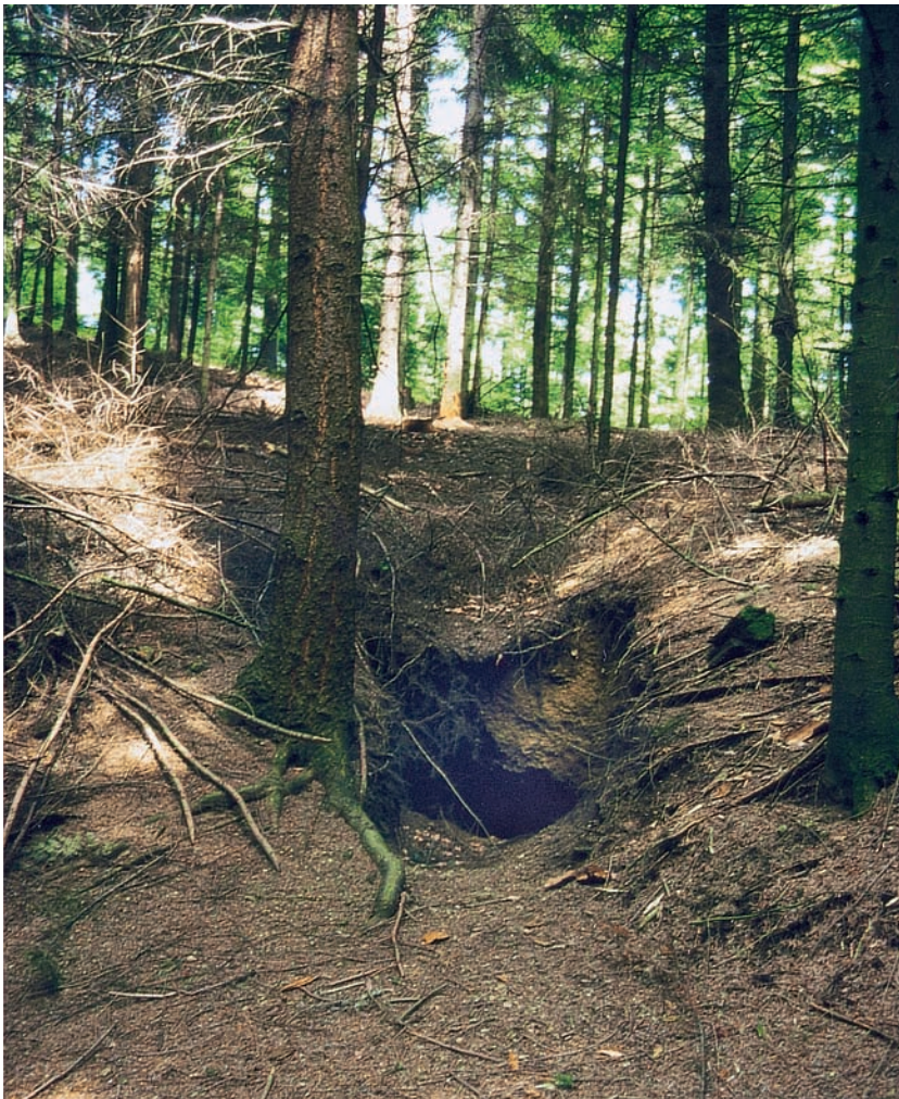
3 Die Wasserscheide zwischen dem Glottertal und Suggental wurde mit einem 70 m langen Stollen unterquert. Hier das eingestürzte Stollenmundloch auf der Suggentäler Seite.
