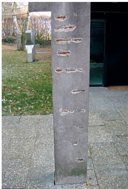
1 Säule im Eingangsbereich mit Schadstellen während der Sanierung.
