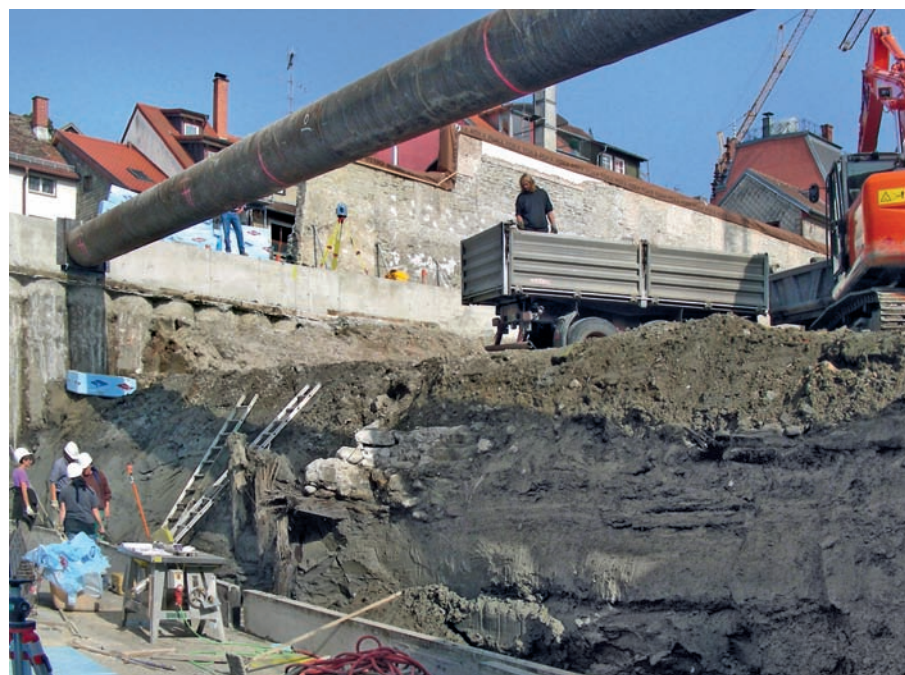
3 Archäologische Dokumentation während der Baumaßnahme. Oben die „Jüngere Stadtmauer“ mit ehemaligem Graben, im Mittelgrund das Fundament der Zwingermauer mit Pfahlrost.
