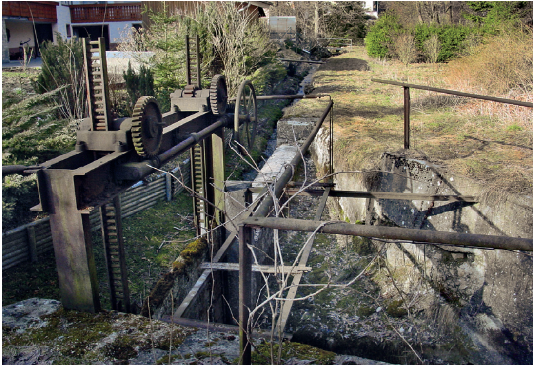
6 Wasserbauliche Anlagen im Oberwasserkanal. Um Hochwasserschäden im nachfolgenden verdolten Teilstück des Oberwasserkanals zu vermeiden, wurde kurz vor dem Doleneinlauf (unten links) eine mechanische Hochwasserentlastung eingebaut: Ab einer bestimmten Wasserspiegellhöhe läuft das von oben kommende Wasser über die Betonschwelle und fließt nach unten rechts wieder in die Aach zurück. Zusätzlich konnte mit dem Hochwasserwehr (links) der gesamte Oberwasserkanal abgelassen und ggf. unterhalten werden.
