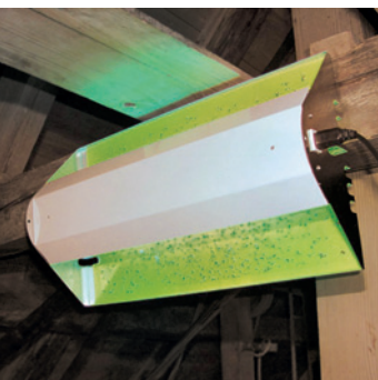
8 Gut besuchte elektri- sche Lichtfalle (FlyTec 40) im Dachgeschoss. Insgesamt wurden drei Fallen installiert, für jedes Stock- werk eine.
