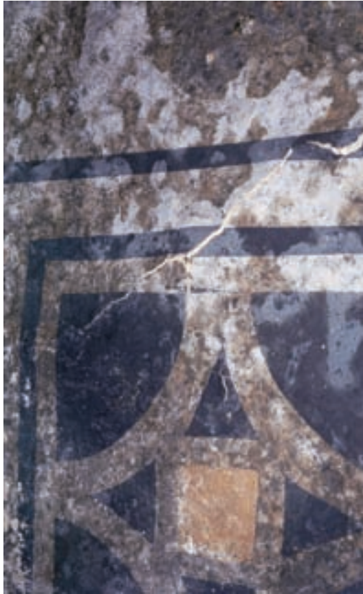
8 Schäden durch Wasserinfiltration, Mittelschiff, Nordostecke.
