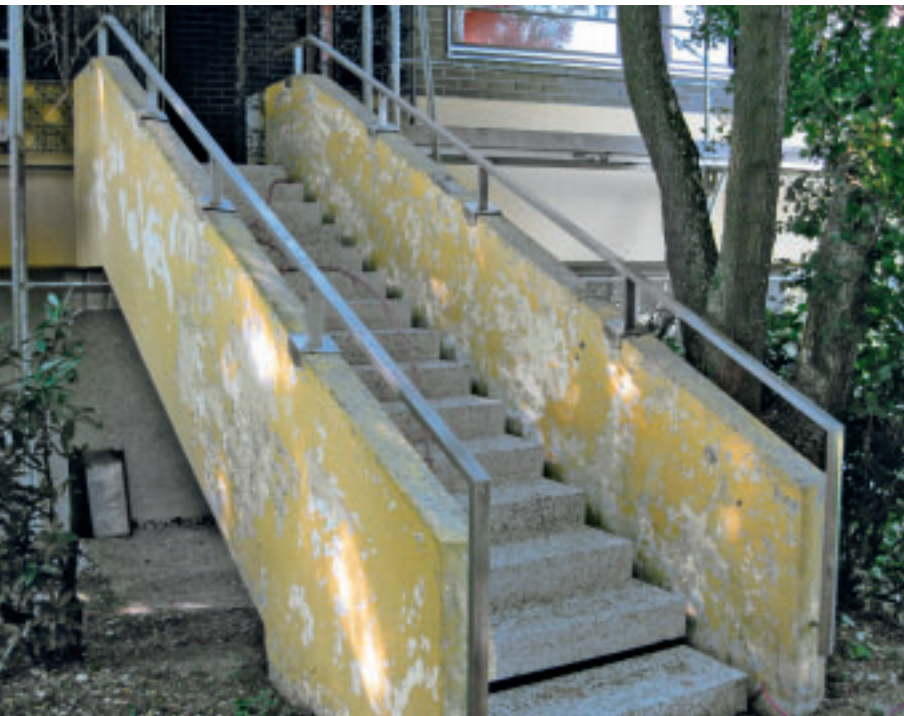
1 Vorzustand. Die hintere Treppe Nord. Abblättern- de gelbe und darunter lie- gende weiße Farbschich- ten, nach nur acht Jahren Witterungsexposition.
